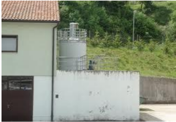
Slika C 4.18 Objekat zgušnjivača mulja na kovencionalnom postrojenju
