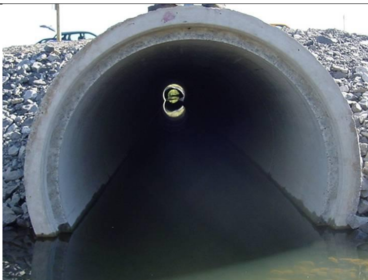
Slika B 1.14 Armirano betonska cijev u kanalizaciji – prolaz ispod saobraćajnice
